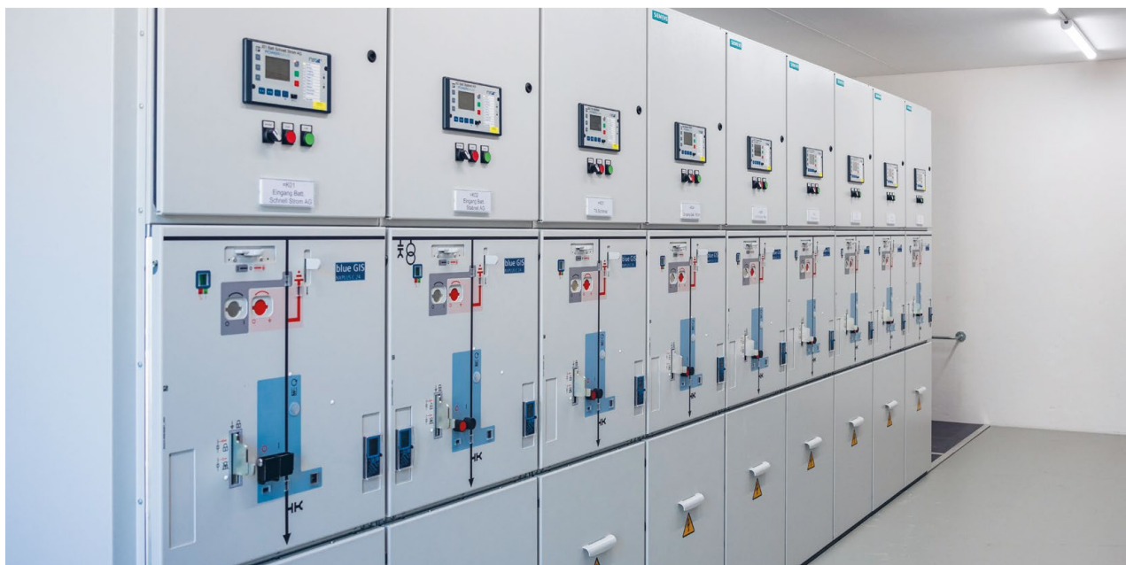
Neue Anlage Trafostation Stoss
