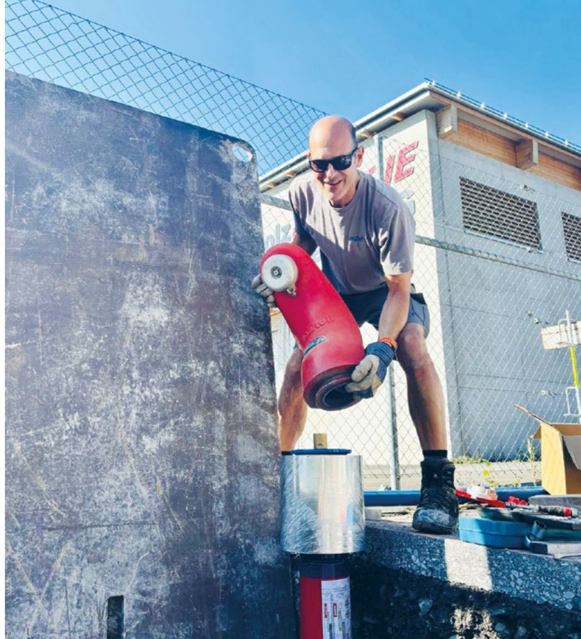
Ersatz Hydrant ARA Kasernenstrasse
