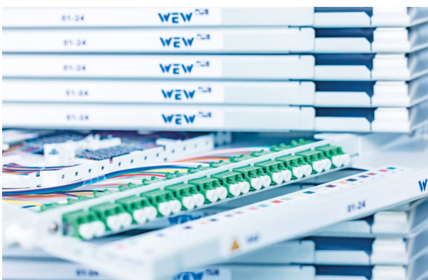
LWL-Ausbau, neue Spleiss- Kassetten
